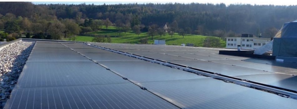
PV-Anlage 180 m 2 / 36 kWp auf dem Attika-Flachdach.
