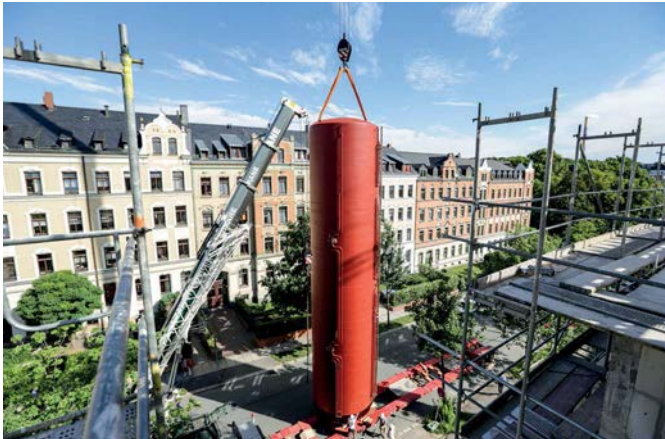
200 m 3 Speicher für ein grosses Solar-Mehrfamilienhaus.
